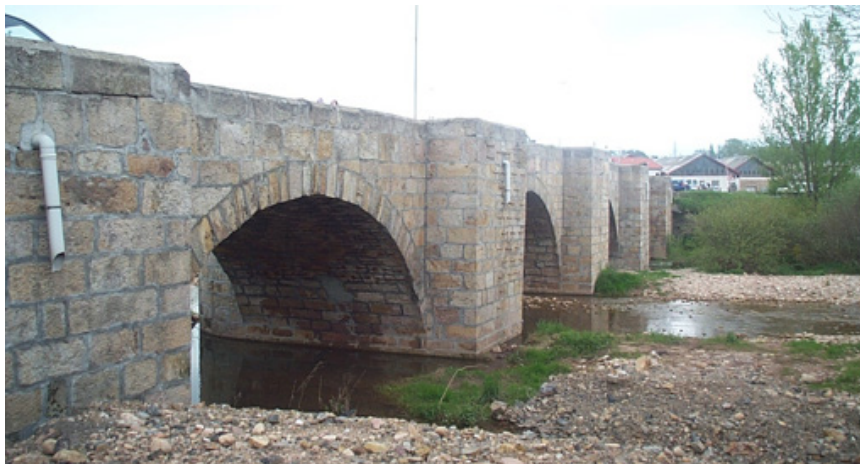
Figura 7. El puente de Matamorosa tras la reparación de 1995 (MRB).
