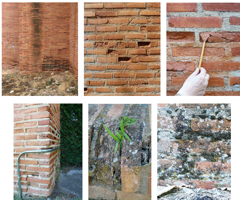
FIGURA 6. Muestra de la manifestación de las diferentes patologías sobre el ladrillo de la Facultad de Farmacia. (García, 2017).
